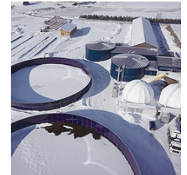
北海道士幌町に建設したバイオガスプラント
