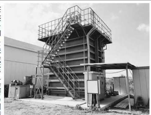
中川水循環セに実験プラント設置
