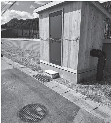
木質建屋の地上式減圧弁室
