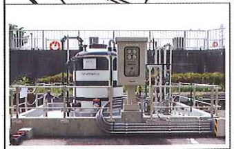
④ 凝集剤注入設備
