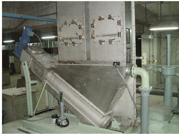
初沈流入水きょう雑物除去用
